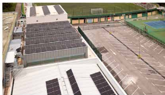
Instalaciones fotovoltaicas en C.D. Amaya
