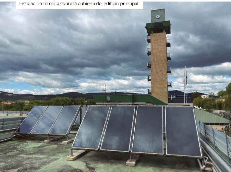
Instalación térmica sobre la cubierta del edificio principal.
