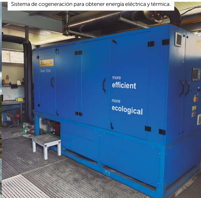
Sistema de cogeneración para obtener energía eléctrica y térmica.
